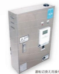
遠隔切換え用操作ボックス
